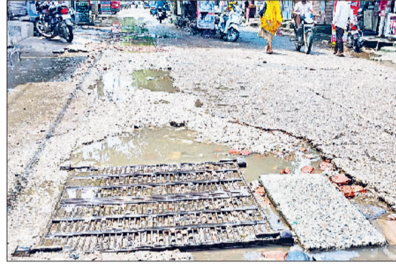
तालाब व बड़ा तालाब में नहरी पानी के लिए पाइप लाइन डाली गई थी। पाइप लाइन डालने के लिए विभाग की ओर से अनाजमंडी के सामने की नई सड़क व ब्रह्मगढ़ के पास सरकुलर रोड की सड़क को तोड़ा गया था। काफी दिनों तक वाहन चालकों को पाइप लाइन के लिए तोड़ी गई सड़क के गड्डों से परेशानी उठानी पड़ी। इसके बाद विभाग की ओर से गड्डों की रिपेयरिंग कर दी गई, लेकिन
